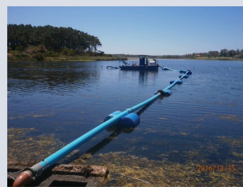
Vista de Balsa y línea de impulsión utilizada en el refulado
